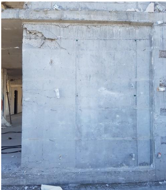
Fig. 6. Concrete fractures of shear walls Рис. 6. Руйнування бетону стіни
