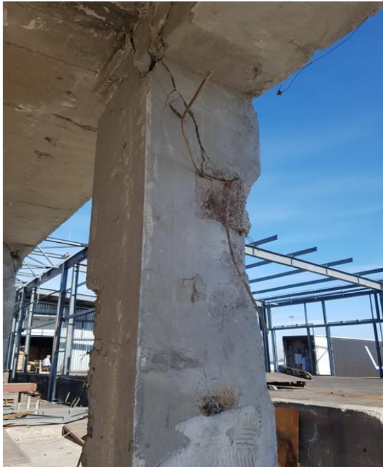
Fig. 4. Concrete fractures of columns Рис. 4. Руйнування бетону колон
