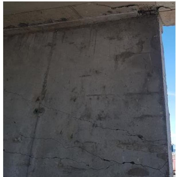
Fig. 7. Wall with cracks more than 2mm wide Рис. 7. Стіна із тріщинами понад 2 мм
