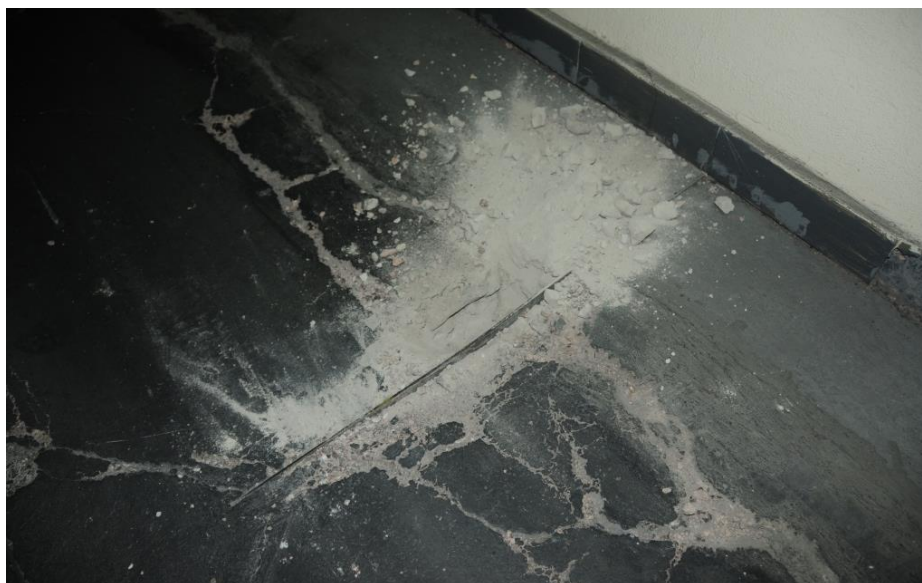
Рис.2. Загальний вигляд конструкції підлоги пошкодженої плити перекриття.
