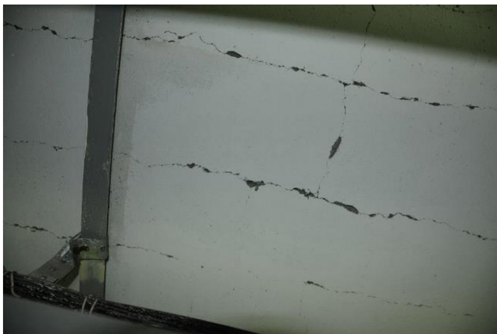
Рис.1. Загальний вигляд нижньої поверхні пошкодженої плити перекриття.
