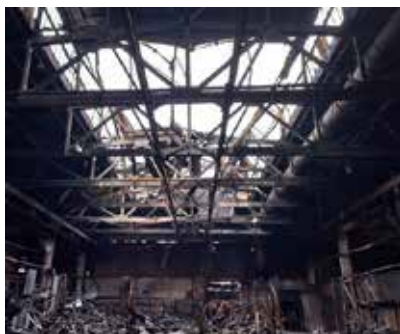
Рис.1 – Обрушення конструкції світлового ліхтаря
