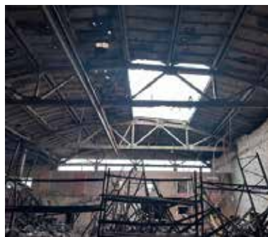
Рис.2 – Руйнування та пошкодження плит покриття внаслідок динамічного удару з наступним розвитком пожежі
