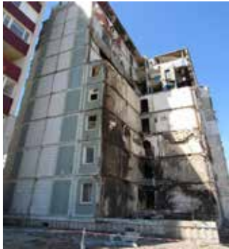
Рис.1 - Руйнування частини блок-секції великопанельного багатоквартирного житлового будинку на вул. захисників України, 25 в м. Умань
